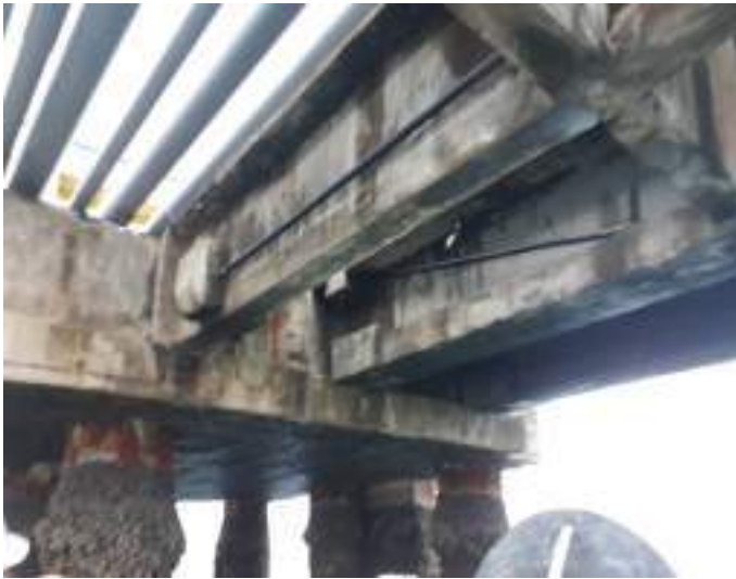
Foto 169: Armaduras apresentando elevado grau de oxidação nas vigas
