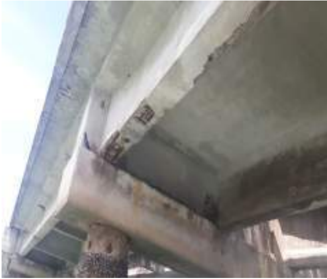
Foto 73: Viga com armaduras visíveis e oxidadas – entre P14 e P15
