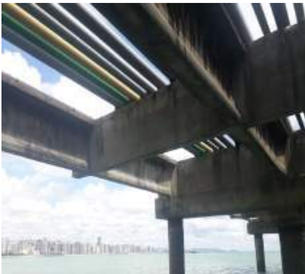
Foto 35: Viga com armaduras visíveis e oxidadas – entre P9 e P10
