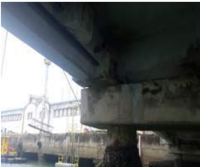
Foto 07: Viga com armaduras visíveis e oxidadas – entre P2 e P3
