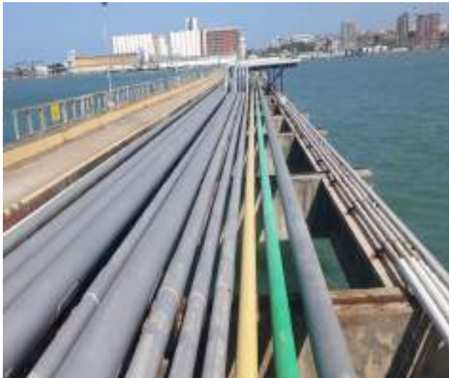
Foto 157: Vista das tubulações
