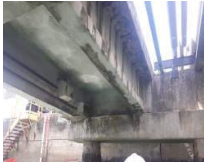
Foto 02: Viga com armaduras visíveis e oxidadas – entre P1 e P2
