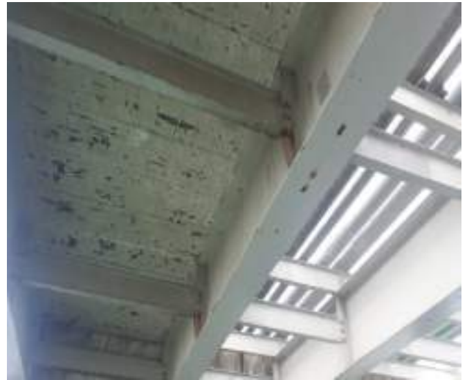
Foto 58: Viga com armaduras visíveis e oxidadas – entre P12 e P13
