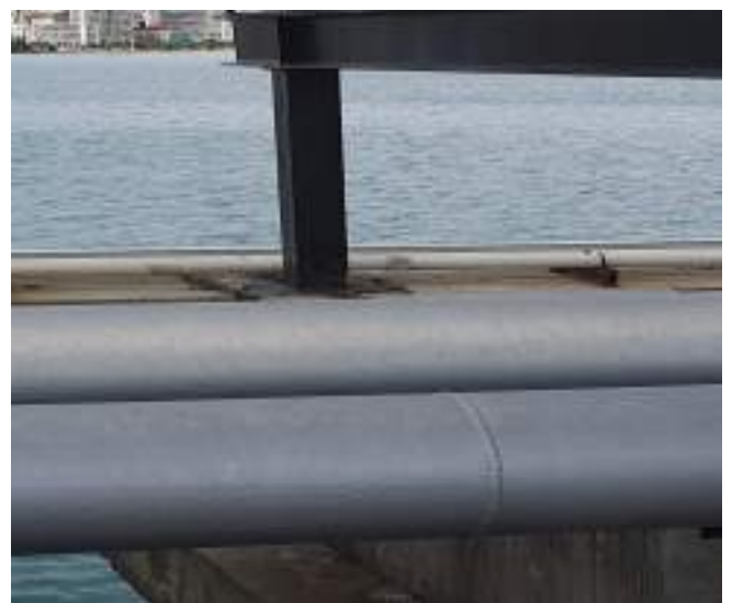
Foto 144: Placa em perfil "U" com elevado grau de oxidação
