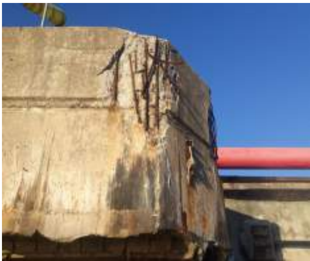
Foto 123: Armaduras visíveis e oxidadas – curva
