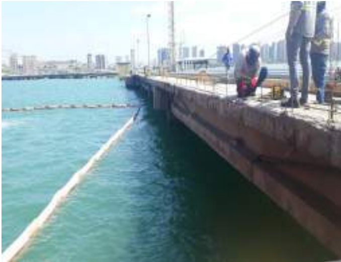
Foto 161: Vigas do píer apresentando oxidação em armaduras
