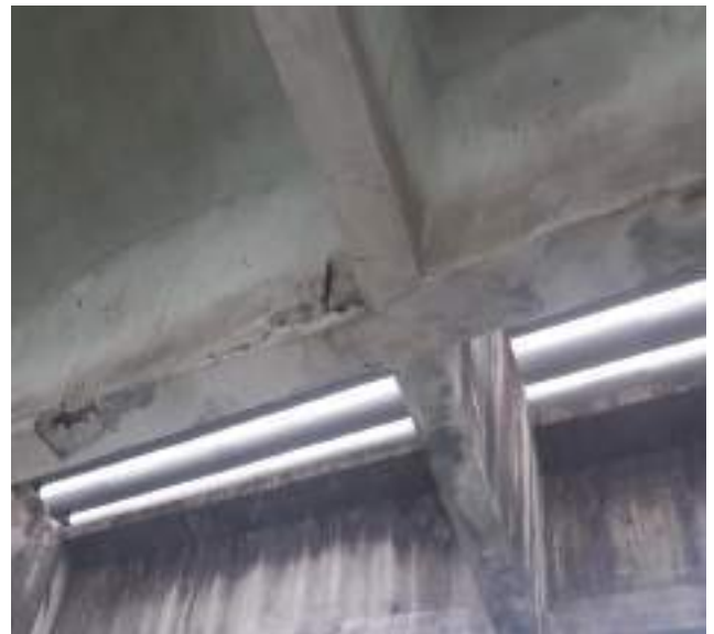
Foto 52: Viga com armaduras visíveis e oxidadas – entre P11 e P12
