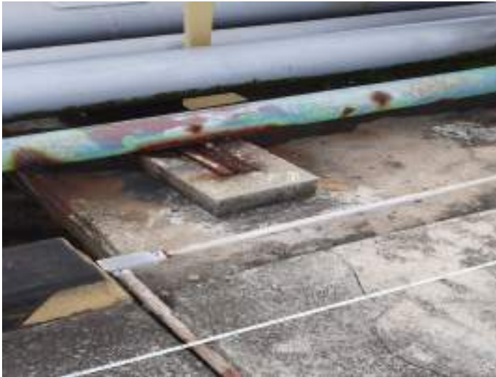
Foto 129: Base metálica da tubulação com elevado grau de oxidação
