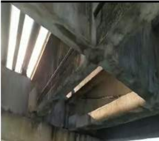
Foto 117: Viga com armaduras visíveis e oxidadas – entre P39 e P40
