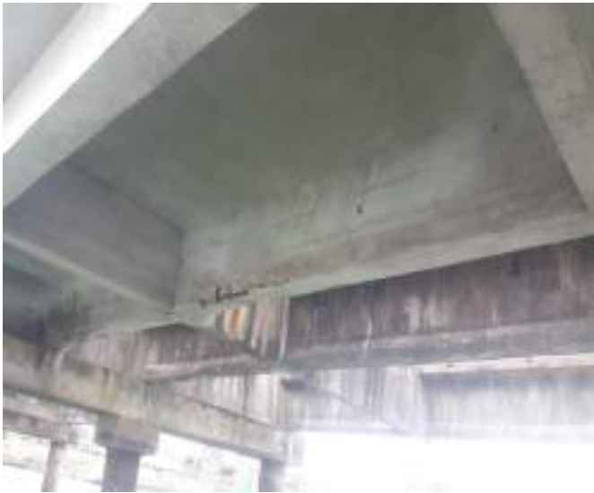
Foto 45: Viga com armaduras visíveis e oxidadas – entre P10 e P11
