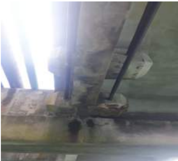
Foto 39: Viga com armaduras visíveis e oxidadas – entre P9 e P10
