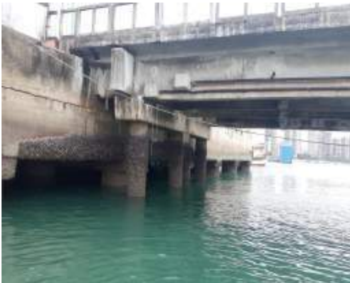
Foto 163: Vigas do píer apresentando oxidação em armaduras
