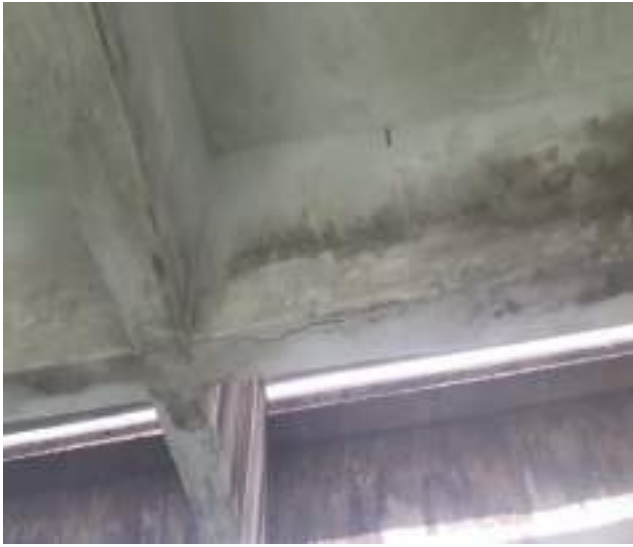
Foto 77: Viga com armaduras visíveis e oxidadas – entre P14 e P15
