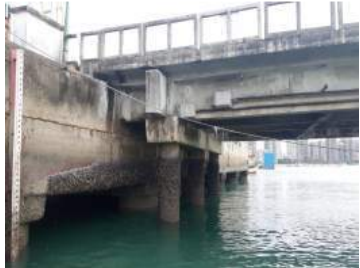
Foto 162: Vigas do píer apresentando oxidação em armaduras
