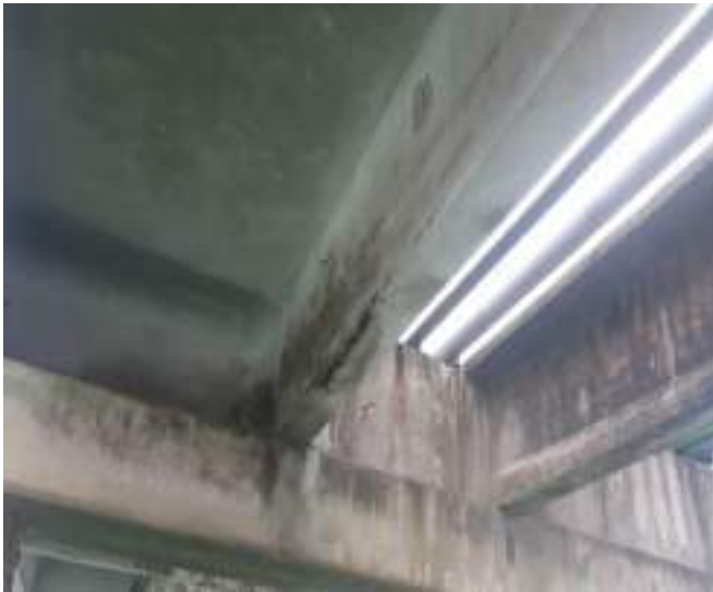
Foto 41: Viga com armaduras visíveis e oxidadas – entre P10 e P11
