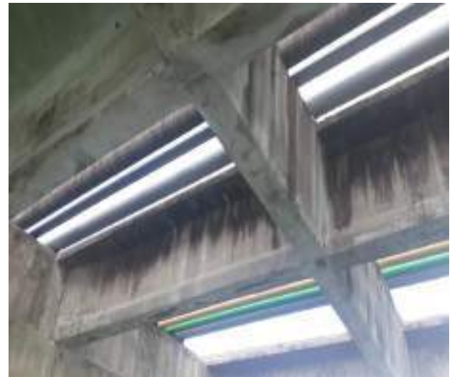
Foto 64: Viga com armaduras visíveis e oxidadas – entre P13 e P14
