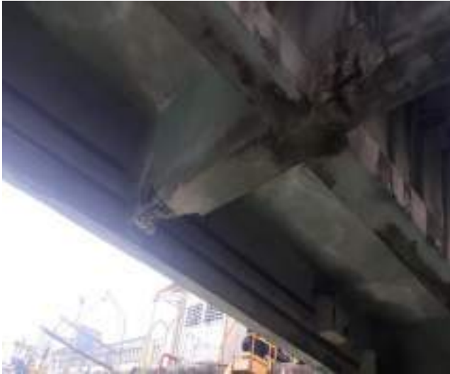
Foto 01: Viga com armaduras visíveis e oxidadas – entre P1 e P2
