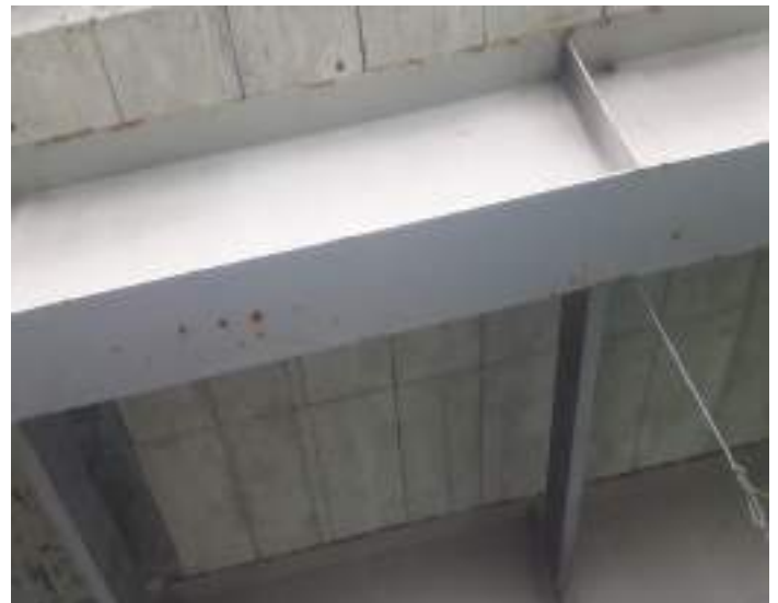
Foto 60: Viga com armaduras visíveis e oxidadas – entre P12 e P13
