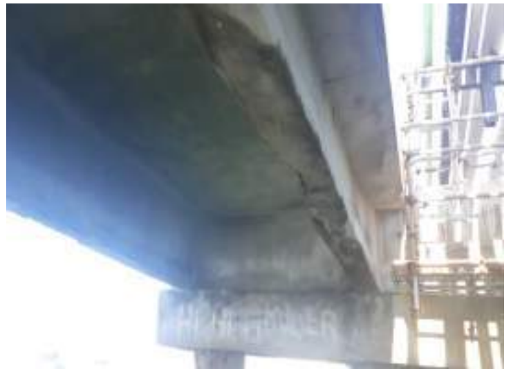
Foto 100: Viga com armaduras visíveis e oxidadas – entre P21 e P22
