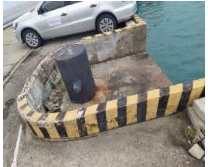
Foto 154: Plataforma com platibandas quebrando
