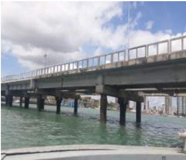
Foto 79: Viga com armaduras visíveis e oxidadas – entre P15 e P16
