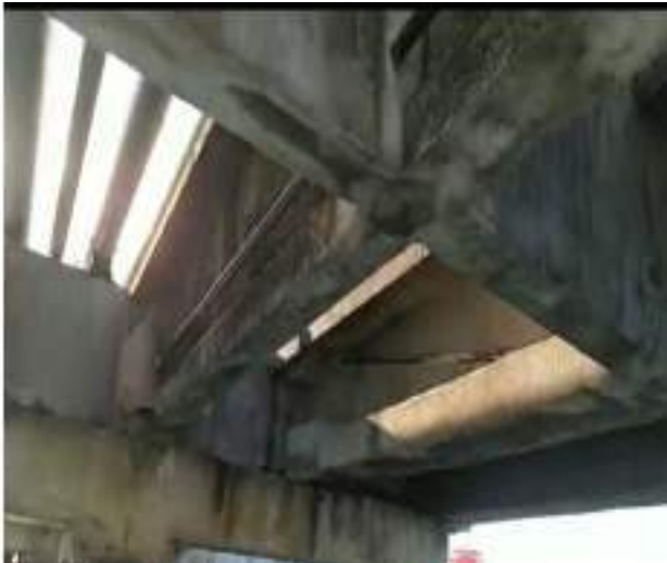
Foto 115: Vigas com fissuras – entre P36 e P37
