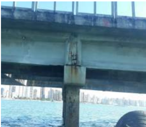
Foto 103: Viga com armaduras visíveis e oxidadas – entre P24 e P25
