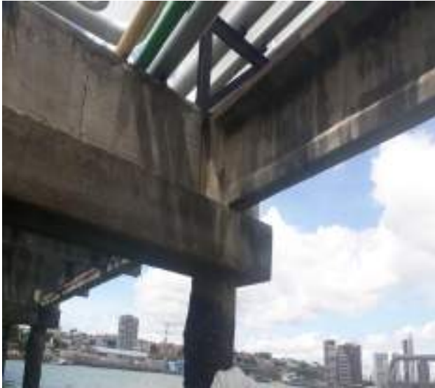
Foto 93: Viga com armaduras visíveis e oxidadas – entre P17 e P18
