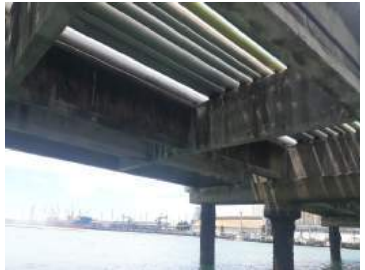
Foto 88: Viga com armaduras visíveis e oxidadas – entre P17 e P18
