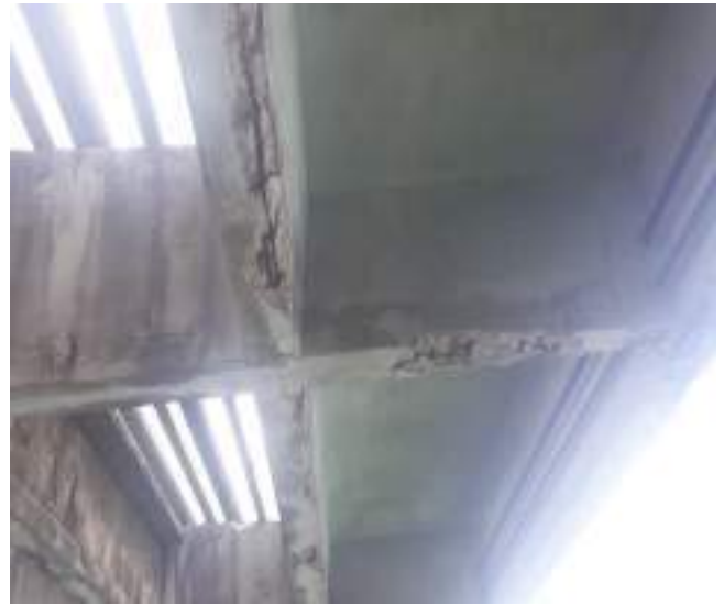
Foto 10: Viga com armaduras visíveis e oxidadas – entre P3 e P4
