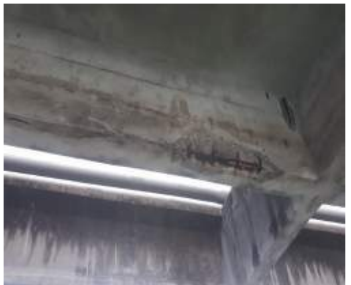
Foto 68: Viga com armaduras visíveis e oxidadas – entre P13 e P14
