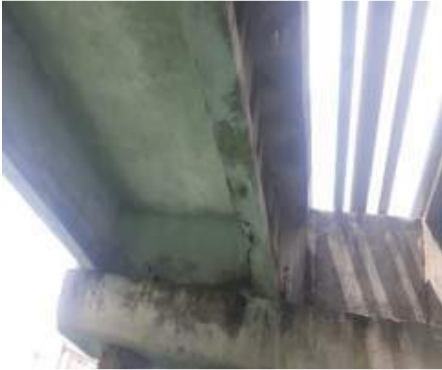
Foto 29: Viga com armaduras visíveis e oxidadas – entre P8 e P9
