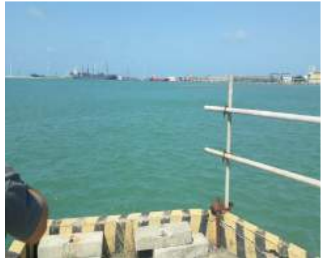
Foto 150: Plataforma com platibandas quebrando
