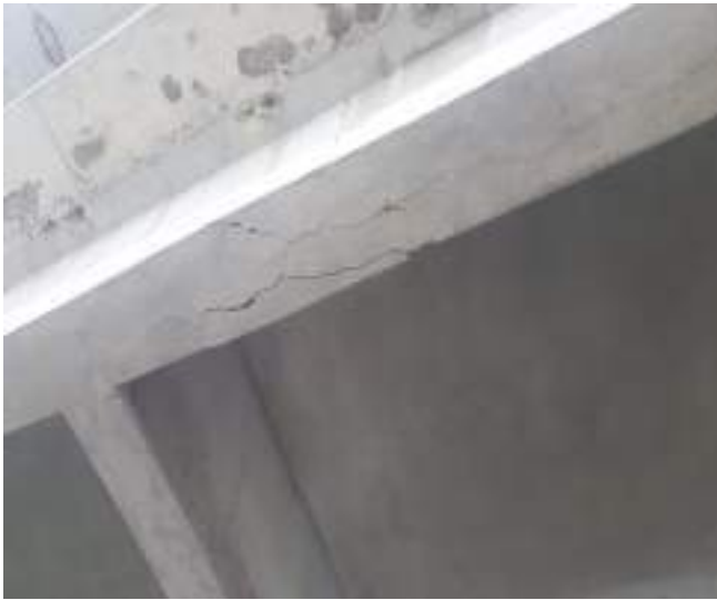
Foto 53: Viga com armaduras visíveis e oxidadas – entre P11 e P12
