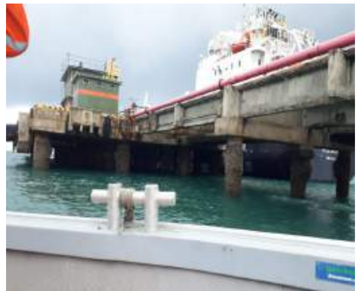
Foto 168: Armaduras apresentando elevado grau de oxidação nas vigas
