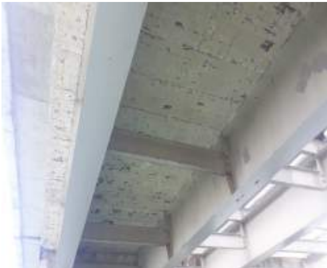
Foto 59: Viga com armaduras visíveis e oxidadas – entre P12 e P13
