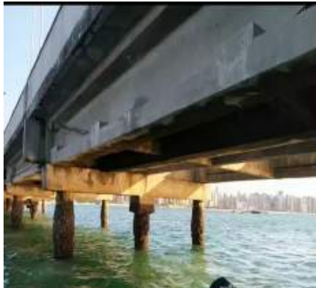
Foto 120: Vigas com fissuras – entre P42 e Plataforma secundária
