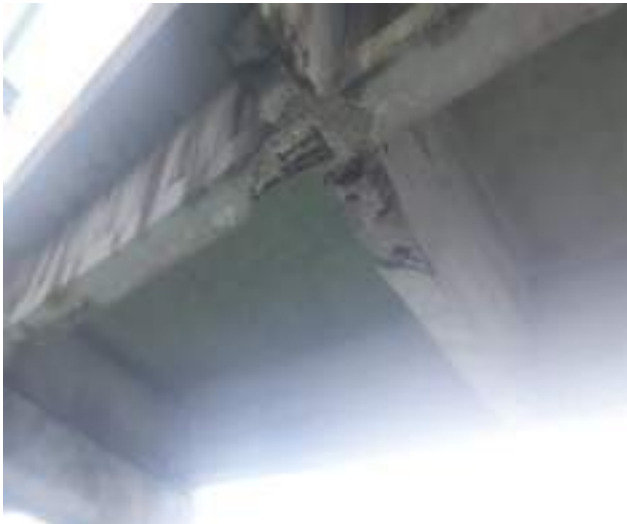
Foto 15: Viga com armaduras visíveis e oxidadas – entre P4 e P5
