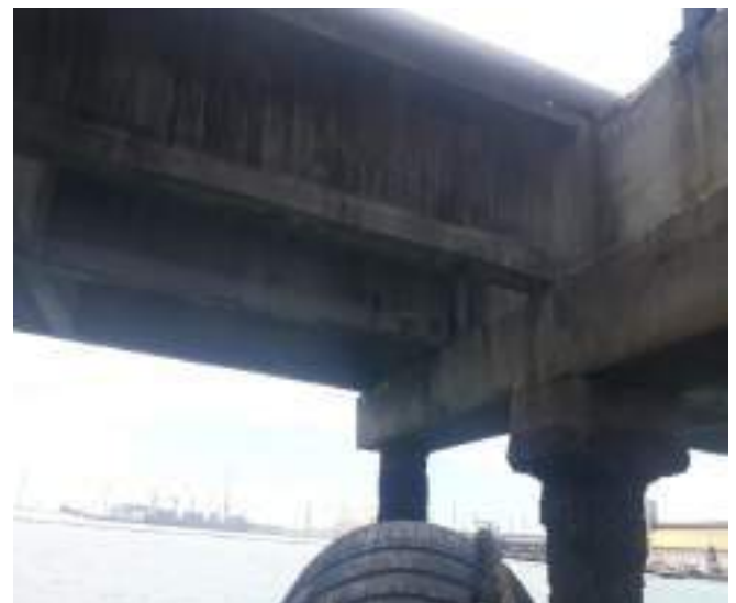
Foto 92: Viga com armaduras visíveis e oxidadas – entre P17 e P18
