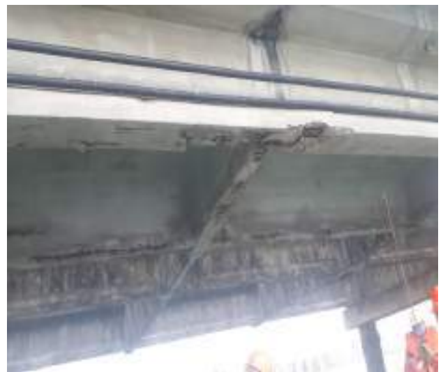
Foto 12: Viga com armaduras visíveis e oxidadas – entre P3 e P4
