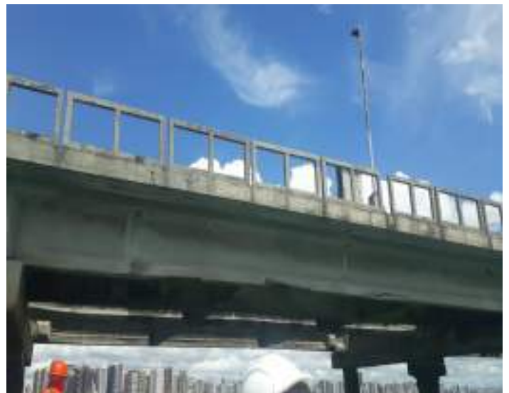
Foto 80: Viga com armaduras visíveis e oxidadas – entre P15 e P16
