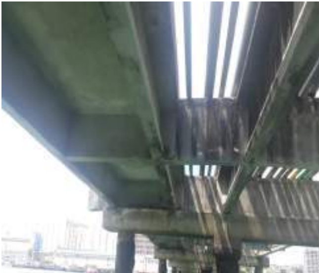
Foto 89: Viga com armaduras visíveis e oxidadas – entre P17 e P18
