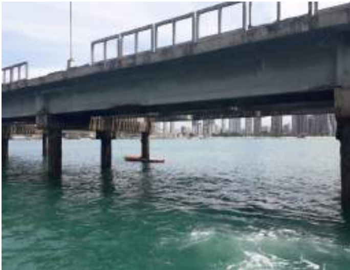
Foto 173: Armaduras apresentando elevado grau de oxidação nas vigas
