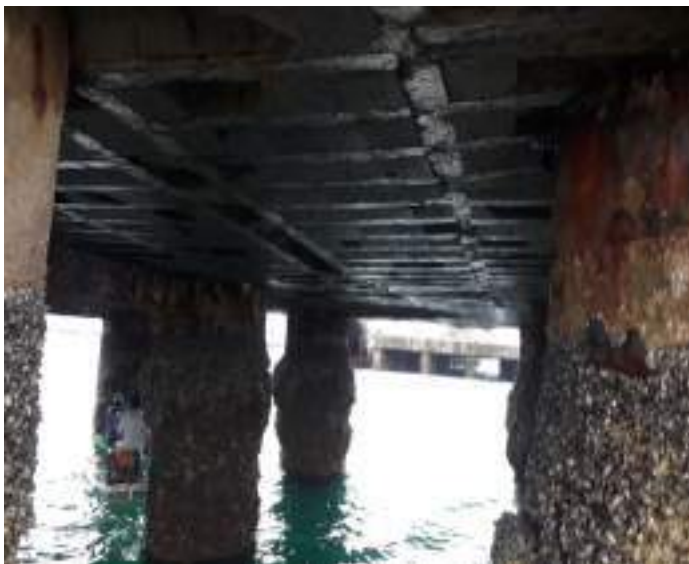
Foto 135: Laje com perda de recobrimento e armadura oxidada
