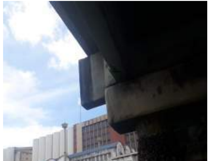
Foto 16: Viga com armaduras visíveis e oxidadas – entre P4 e P5
