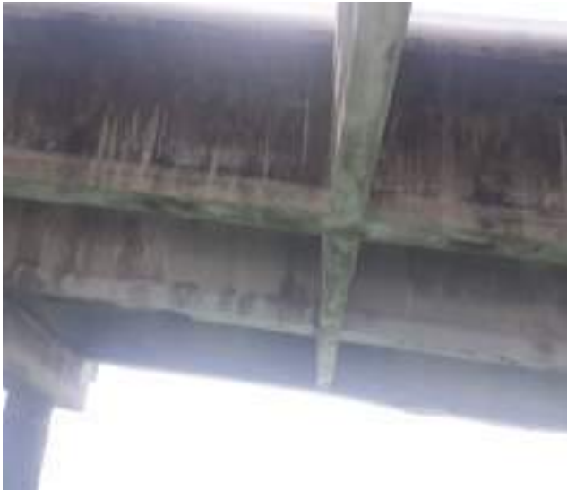
Foto 85: Viga com armaduras visíveis e oxidadas – entre P15 e P16
