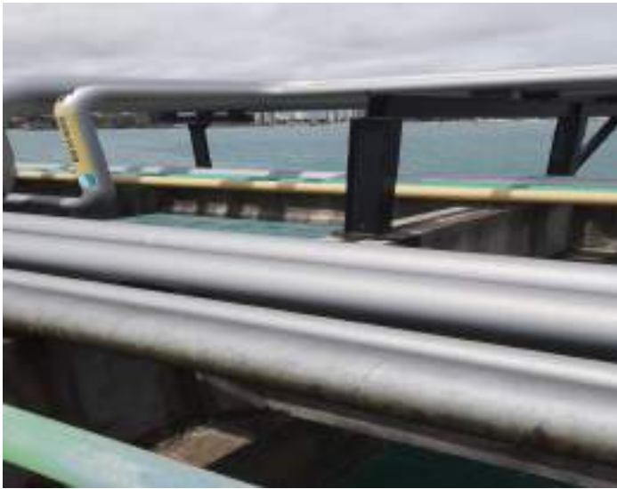
Foto 125: Base metálica de tubulações bastante oxidada
