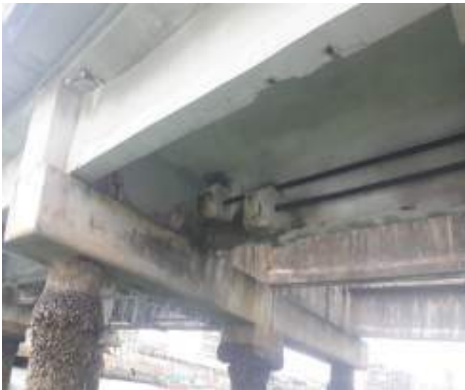
Foto 19: Viga com armaduras visíveis e oxidadas – entre P5 e P6
