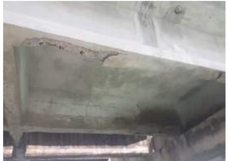
Foto 34: Viga com armaduras visíveis e oxidadas – entre P8 e P9
