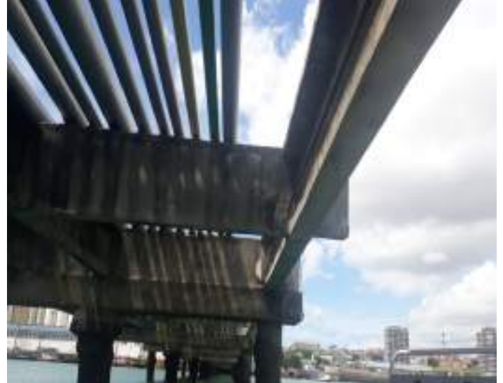
Foto 86: Viga com armaduras visíveis e oxidadas – entre P15 e P16
