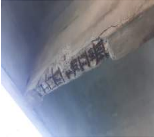
Foto 105: Viga com armaduras visíveis e oxidadas – entre P26 e P27
