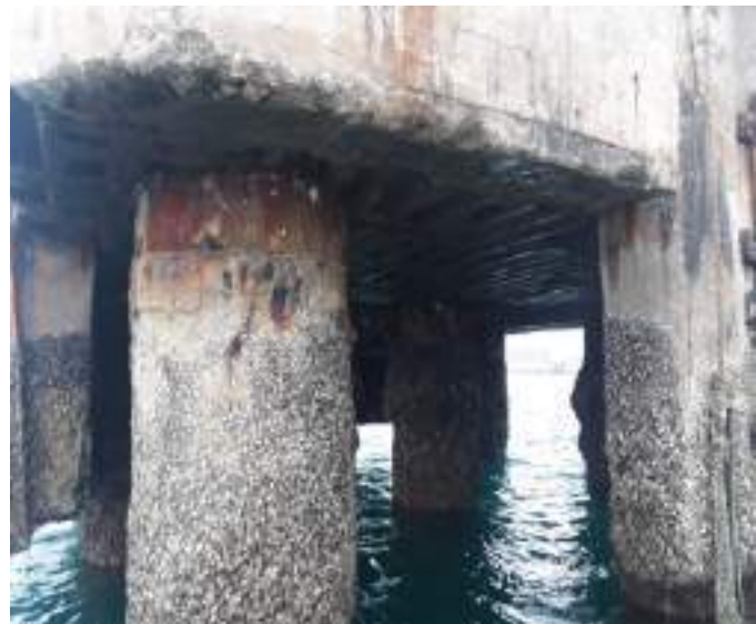
Foto 132: Laje com perda de recobrimento e armadura oxidada
