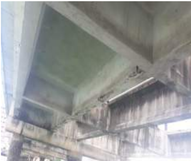
Foto 55: Viga com armaduras visíveis e oxidadas – entre P11 e P12
