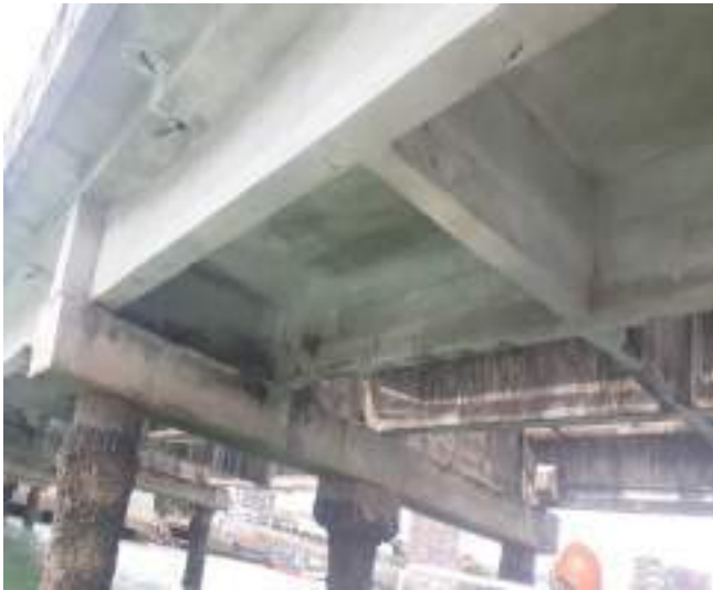
Foto 21: Viga com armaduras visíveis e oxidadas – entre P6 e P7 P7
