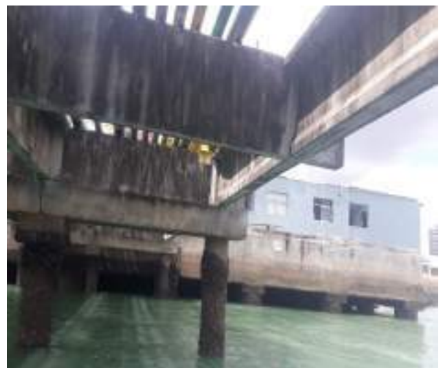
Foto 04: Viga com armaduras visíveis e oxidadas – entre P2 e P3
