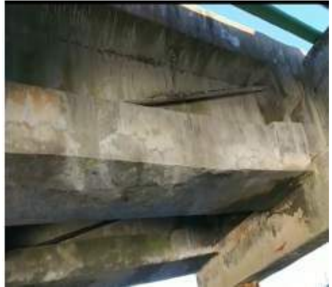
Foto 118: Vigas com fissuras – entre P40 e P41
