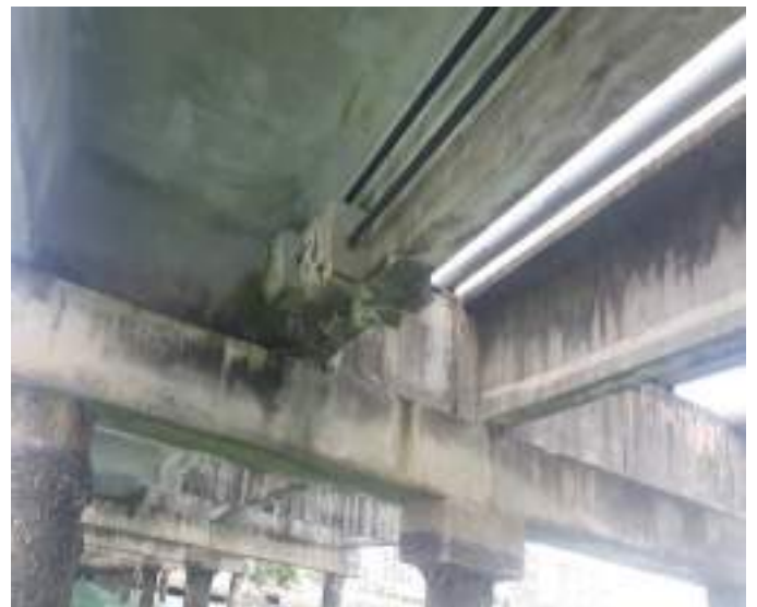
Foto 36: Viga com armaduras visíveis e oxidadas – entre P9 e P10
