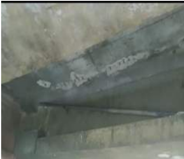
Foto 121: Viga com armaduras visíveis e oxidadas – entre P43 e P44
