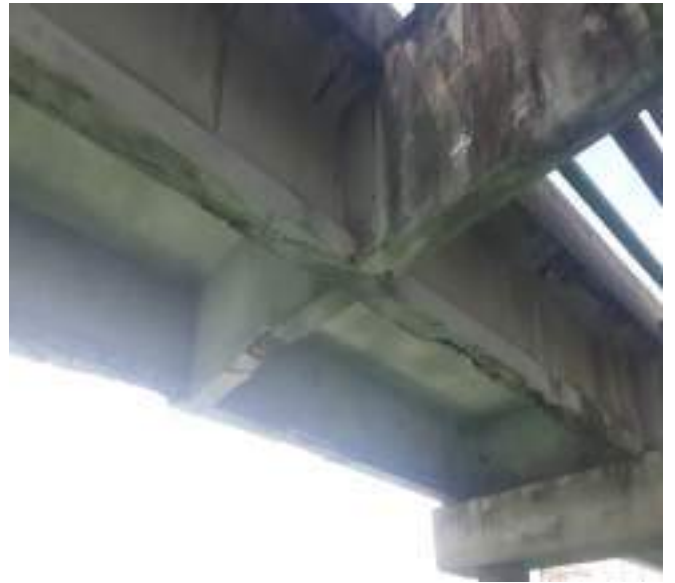
Foto 82: Viga com armaduras visíveis e oxidadas – entre P15 e P16
