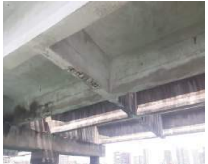
Foto 32: Viga com armaduras visíveis e oxidadas – entre P8 e P9
