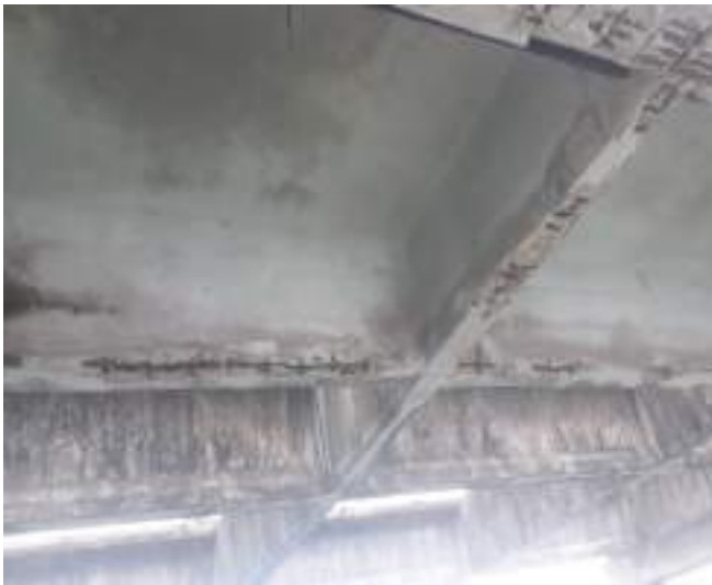
Foto 11: Viga com armaduras visíveis e oxidadas – entre P3 e P4
