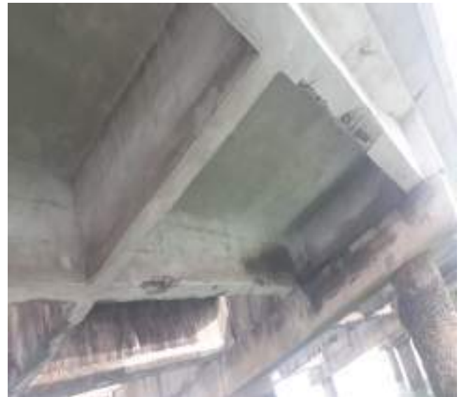
Foto 28: Viga com armaduras visíveis e oxidadas – entre P7 e P8
