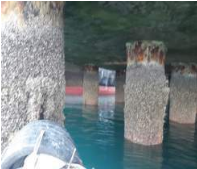
Foto 137: Laje com perda de recobrimento e armadura oxidada
