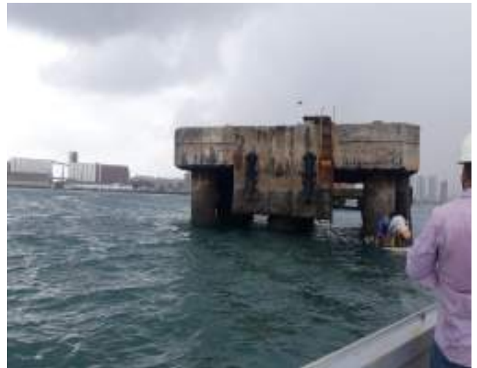
Foto 166: Armaduras apresentando elevado grau de oxidação
