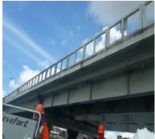
Foto 62: Viga com armaduras visíveis e oxidadas – entre P12 e P13
