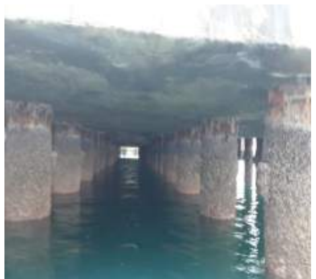
Foto 136: Laje com perda de recobrimento e armadura oxidada
