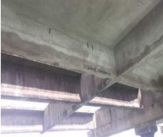
Foto 31: Viga com armaduras visíveis e oxidadas – entre P8 e P9
