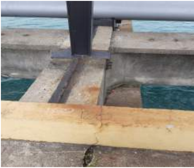
Foto 145: Placa em perfil “U” com elevado grau de oxidação
