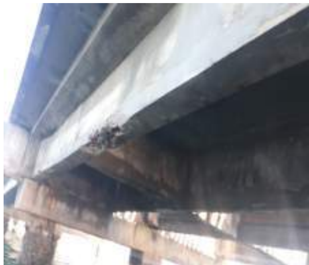
Foto 116: Viga com armaduras visíveis e oxidadas – entre P37 e P38 (último jogo de pilares antes da curva)
