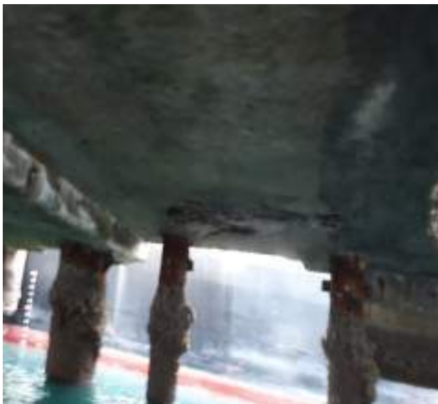
Foto 139: Laje com perda de recobrimento e armadura oxidada
