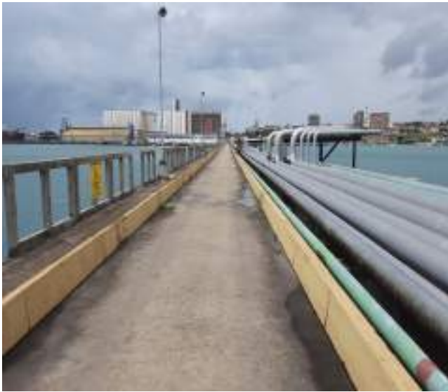
Foto 141: Vista da ponte com guarda-corpos quebrados
