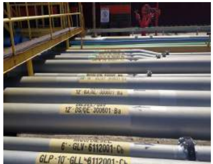
Foto 156: Vista das tubulações
