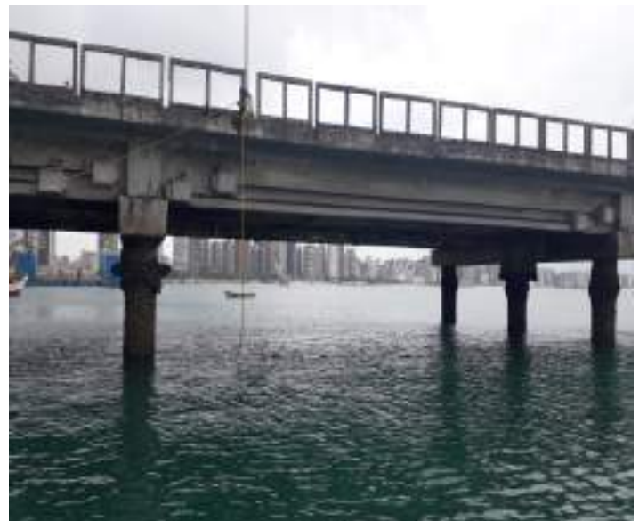
Foto 164: Vigas do píer apresentando oxidação em armaduras
