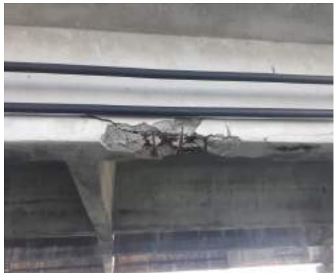
Foto 112: Viga com armaduras visíveis e oxidadas – entre P33 e P34
