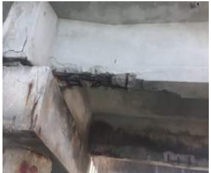
Foto 108: Viga com armaduras visíveis e oxidadas – entre P29 e P30
