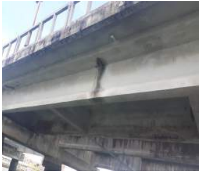
Foto 70: Viga com armaduras visíveis e oxidadas – entre P13 e P14
