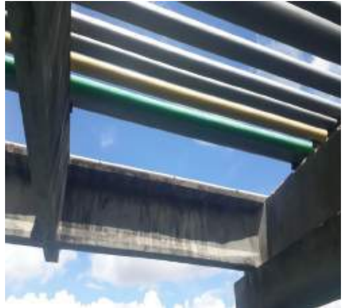
Foto 76: Viga com armaduras visíveis e oxidadas – entre P14 e P15
