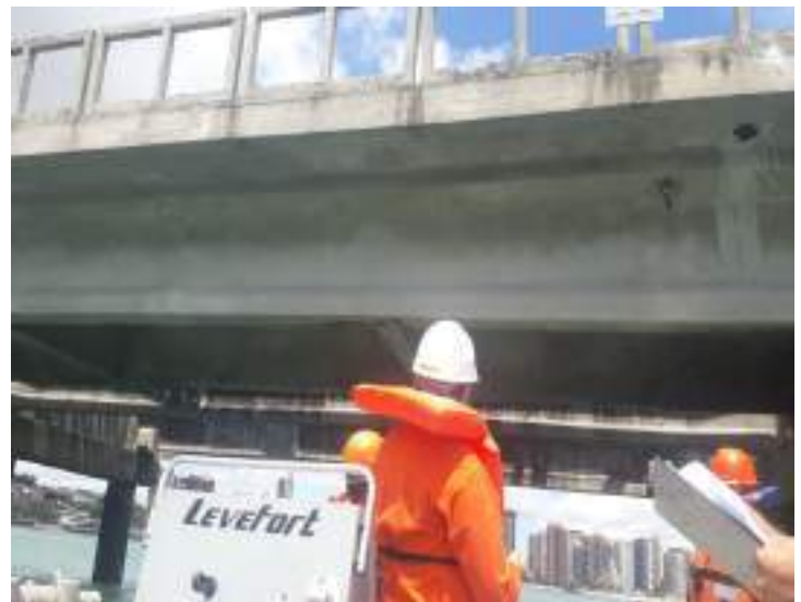
Foto 90: Viga com armaduras visíveis e oxidadas – entre P17 e P18
