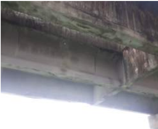
Foto 83: Viga com armaduras visíveis e oxidadas – entre P15 e P16
