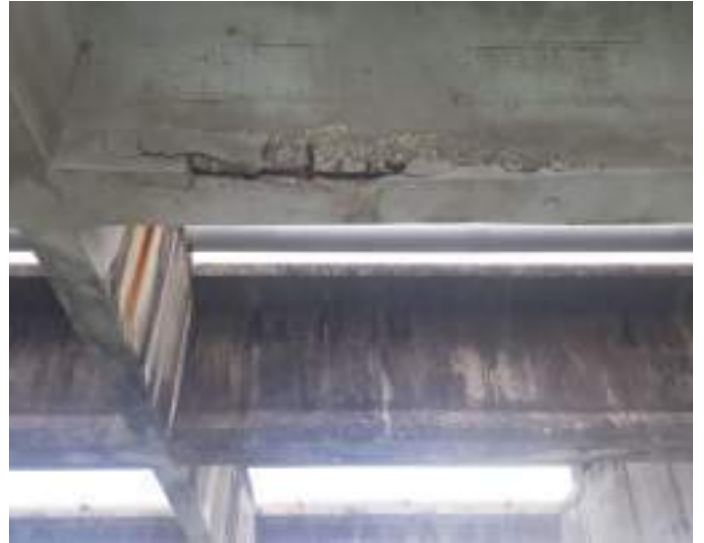
Foto 42: Viga com armaduras visíveis e oxidadas – entre P10 e P11
