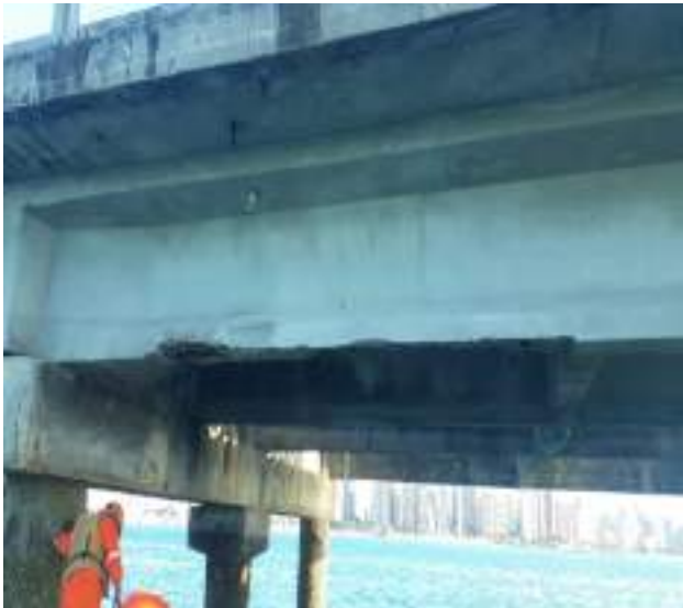
Foto 109: Viga com armaduras visíveis e oxidadas – entre P30 e P31
