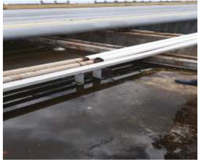
Foto 126: Tubulação na plataforma com elevado grau de oxidação
