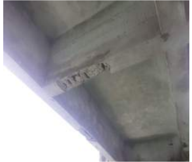
Foto 26: Viga com armaduras visíveis e oxidadas – entre P7 e P8
