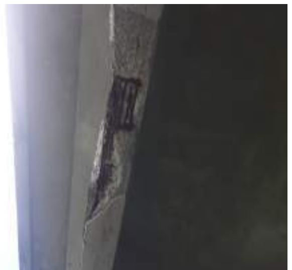
Foto 96: Viga com armaduras visíveis e oxidadas – entre P17 e P18
