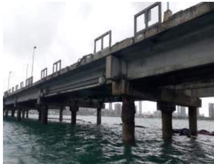
Foto 172: Armaduras apresentando elevado grau de oxidação nas vigas
