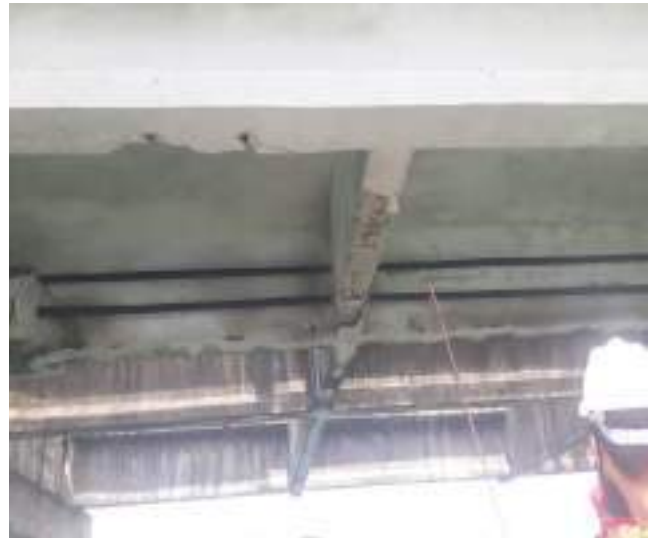
Foto 18: Viga com armaduras visíveis e oxidadas – entre P5 e P6
