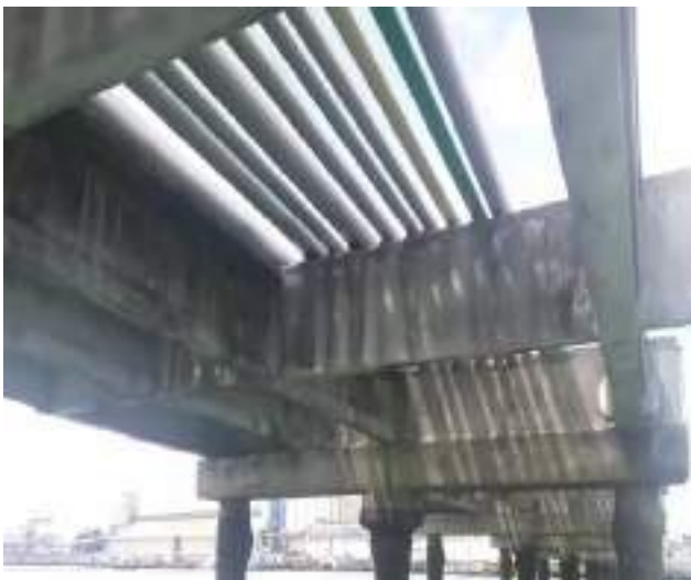
Foto 87: Viga com armaduras visíveis e oxidadas – entre P16 e P17
