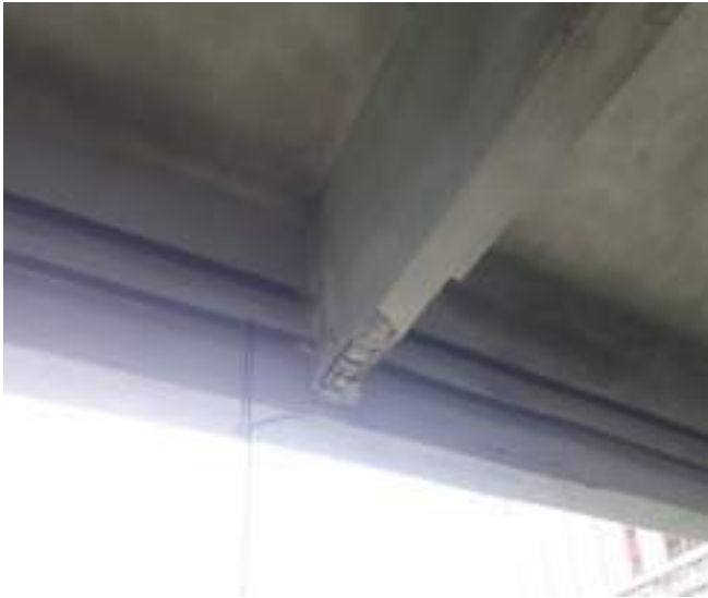
Foto 05: Viga com armaduras visíveis e oxidadas – entre P2 e P3
