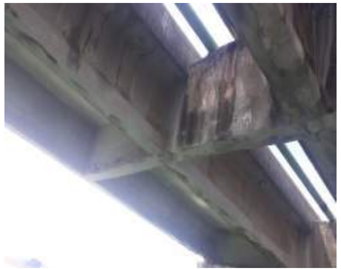
Foto 74: Viga com armaduras visíveis e oxidadas – entre P14 e P15
