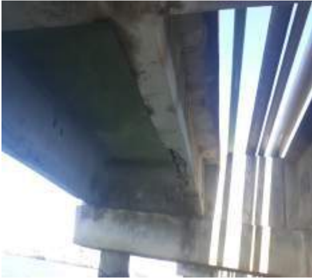
Foto 97: Viga com armaduras visíveis e oxidadas – entre P18 e P19
