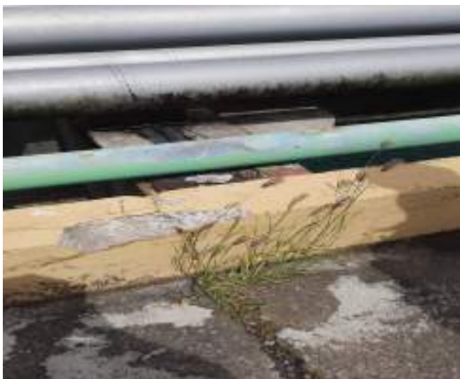
Foto 151: Plataforma com platibandas quebrando
