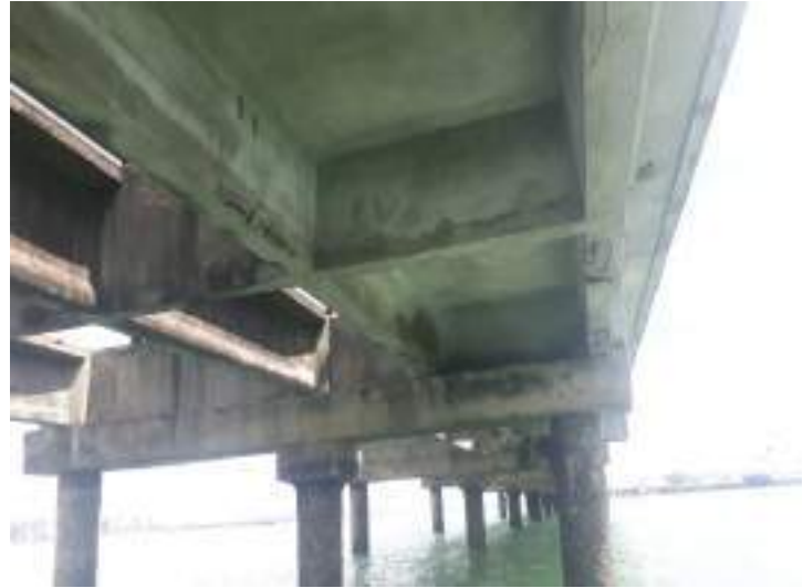
Foto 30: Viga com armaduras visíveis e oxidadas – entre P8 e P9
