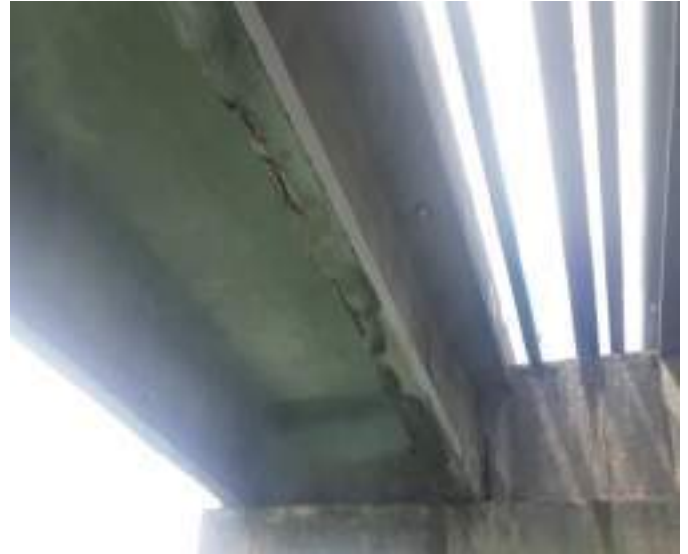
Foto 94: Viga com armaduras visíveis e oxidadas – entre P17 e P18
