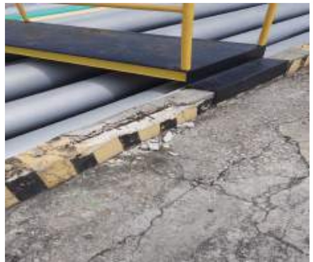
Foto 152: Plataforma com platibandas quebrando
