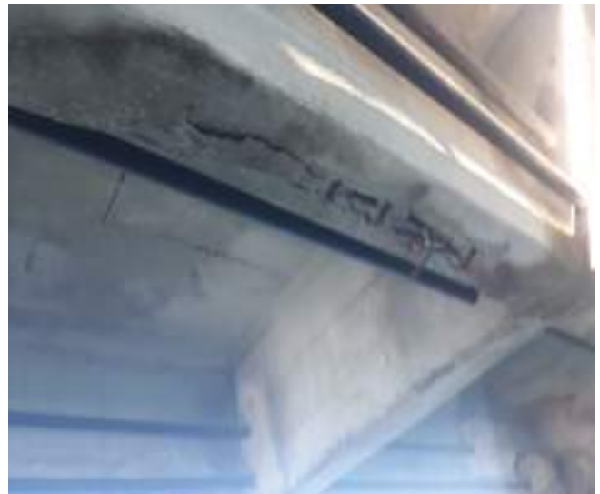
Foto 114: Viga com armaduras visíveis e oxidadas – entre P35 e P36
