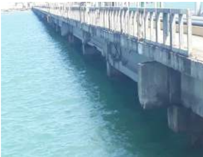
Foto 175: Armaduras apresentando elevado grau de oxidação nas vigas
