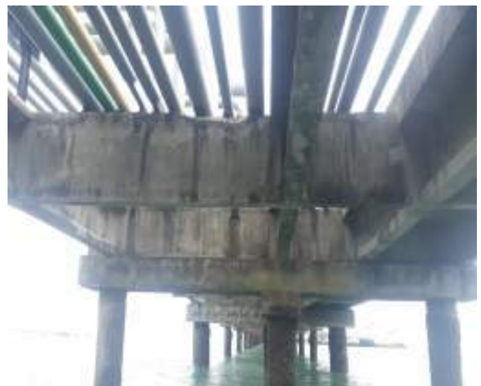
Foto 40: Viga com armaduras visíveis e oxidadas – entre P10 e P11
