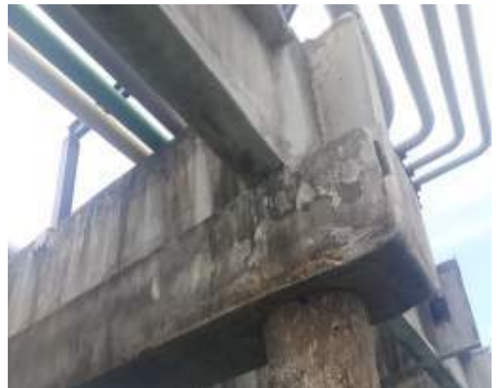
Foto 48: Viga com armaduras visíveis e oxidadas – entre P11 e P12
