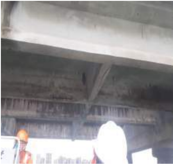
Foto 69: Viga com armaduras visíveis e oxidadas – entre P13 e P14
