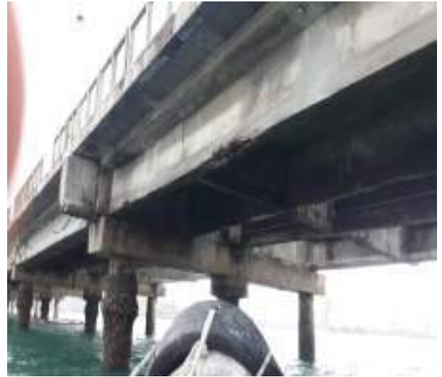
Foto 170: Armaduras apresentando elevado grau de oxidação nas vigas
