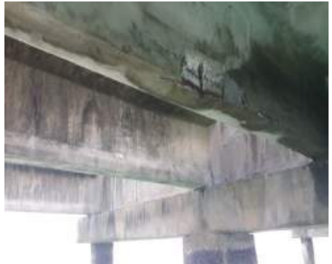
Foto 174: Armaduras apresentando elevado grau de oxidação nas vigas
