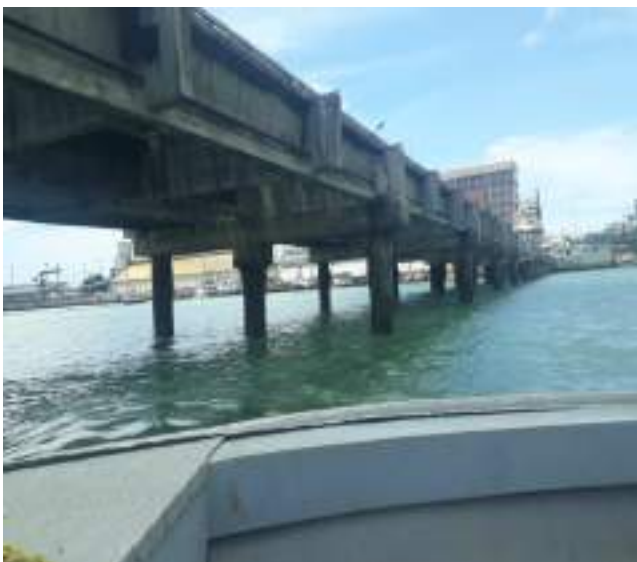
Foto 91: Viga com armaduras visíveis e oxidadas – entre P17 e P18
