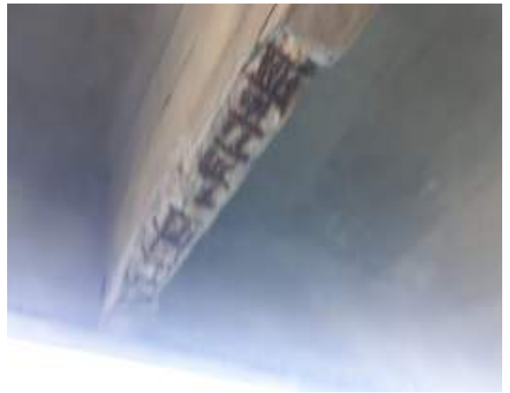
Foto 106: Viga com armaduras visíveis e oxidadas – entre P27 e P28
