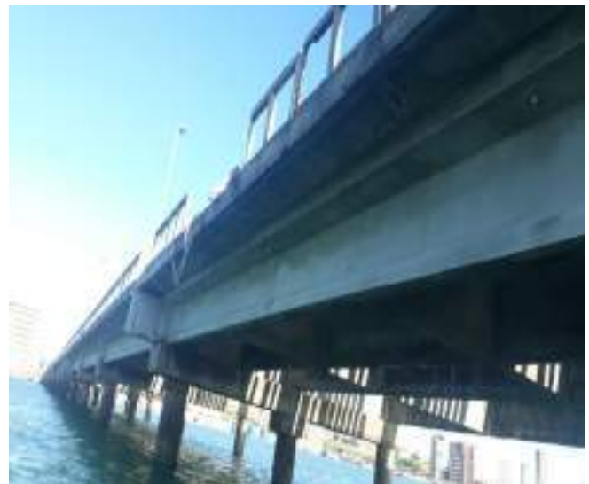
Foto 104: Viga com fissuras – entre P25 e P26
