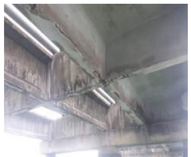
Foto 08: Viga com armaduras visíveis e oxidadas – entre P3 e P4
