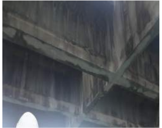
Foto 14: Viga com armaduras visíveis e oxidadas – entre P4 e P5
