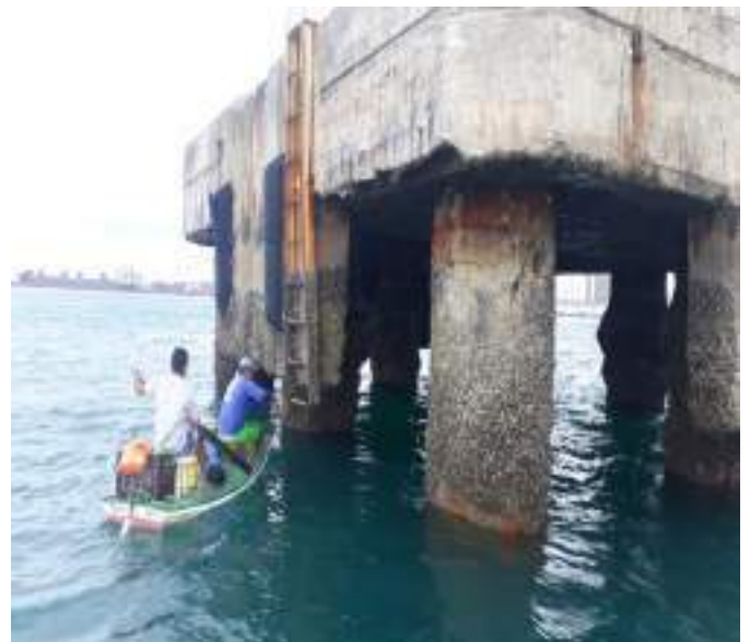
Foto 140: Laje com perda de recobrimento e armadura oxidada
