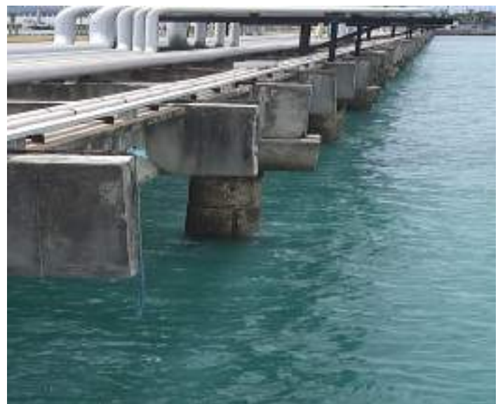
Foto 128: Ferro de sustentação de tub. saindo do eixo das vigas
