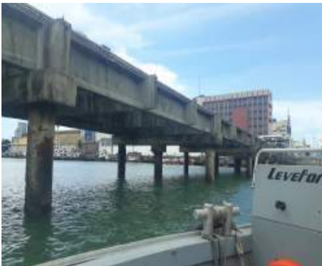
Foto 47: Viga com armaduras visíveis e oxidadas – entre P11 e P12
