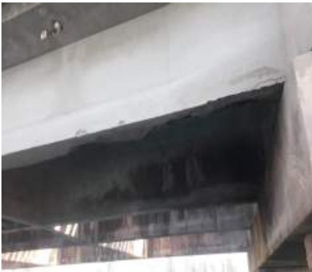
Foto 107: Viga com armaduras visíveis e oxidadas – entre P28 e P29
