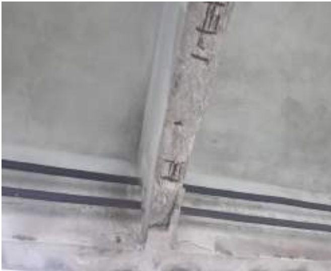
Foto 17: Viga com armaduras visíveis e oxidadas – entre P5 e P6
