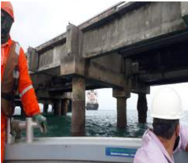
Foto 171: Armaduras apresentando elevado grau de oxidação nas vigas
