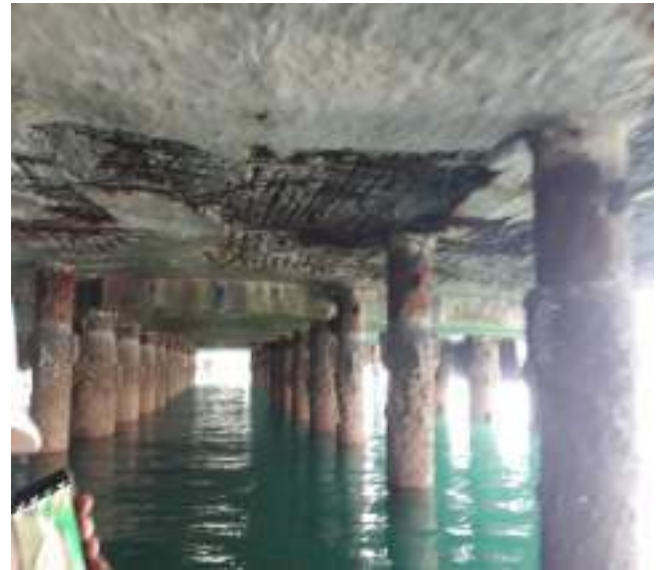
Foto 138: Laje com perda de recobrimento e armadura oxidada
