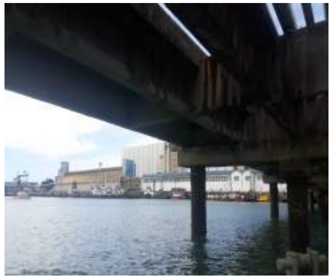
Foto 46: Viga com armaduras visíveis e oxidadas – entre P10 e P11
