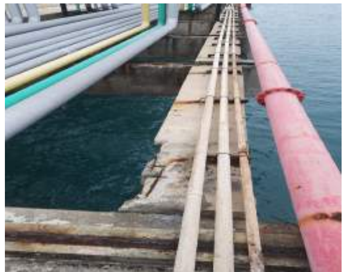
Foto 160: Vigas apresentando oxidação em armaduras
