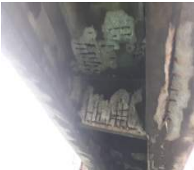
Foto 159: Vigas e lajes apresentando oxidação em armaduras
