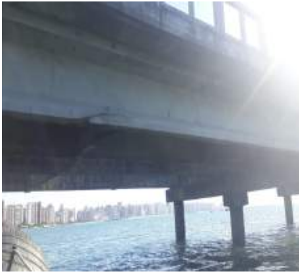
Foto 101: Viga com armaduras visíveis e oxidadas – entre P22 e P23
