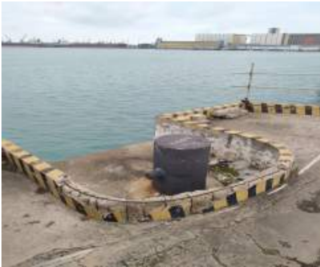
Foto 153: Plataforma com platibandas quebrando
