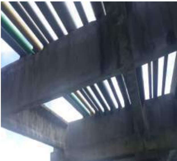
Foto 67: Viga com armaduras visíveis e oxidadas – entre P13 e P14
