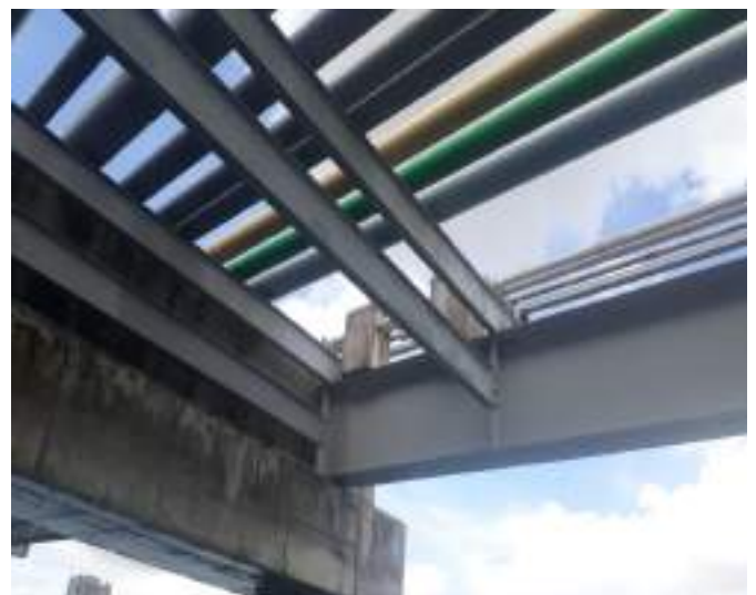
Foto 56: Viga com armaduras visíveis e oxidadas – entre P12 e P13
