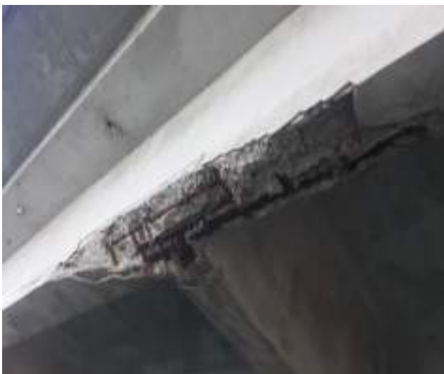
Foto 111: Viga com armaduras visíveis e oxidadas – entre P32 e P33
