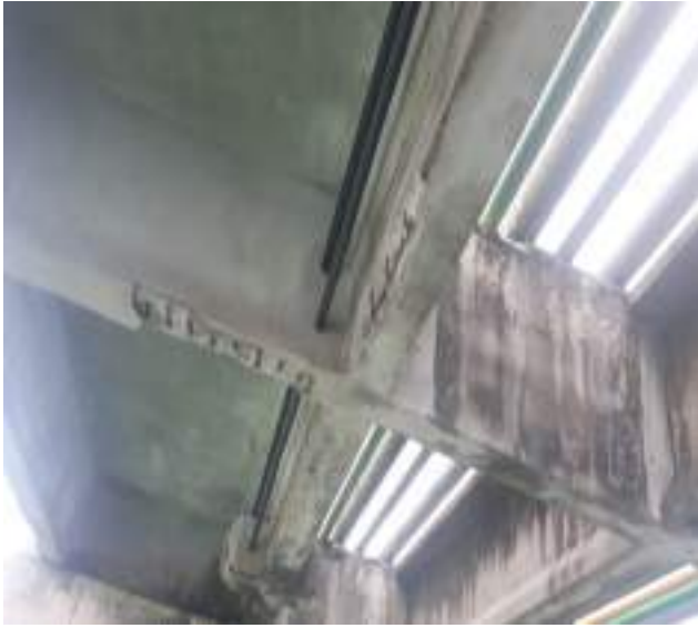
Foto 37: Viga com armaduras visíveis e oxidadas – entre P9 e P10
