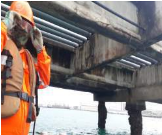
Foto 167: Armaduras apresentando elevado grau de oxidação nas vigas
