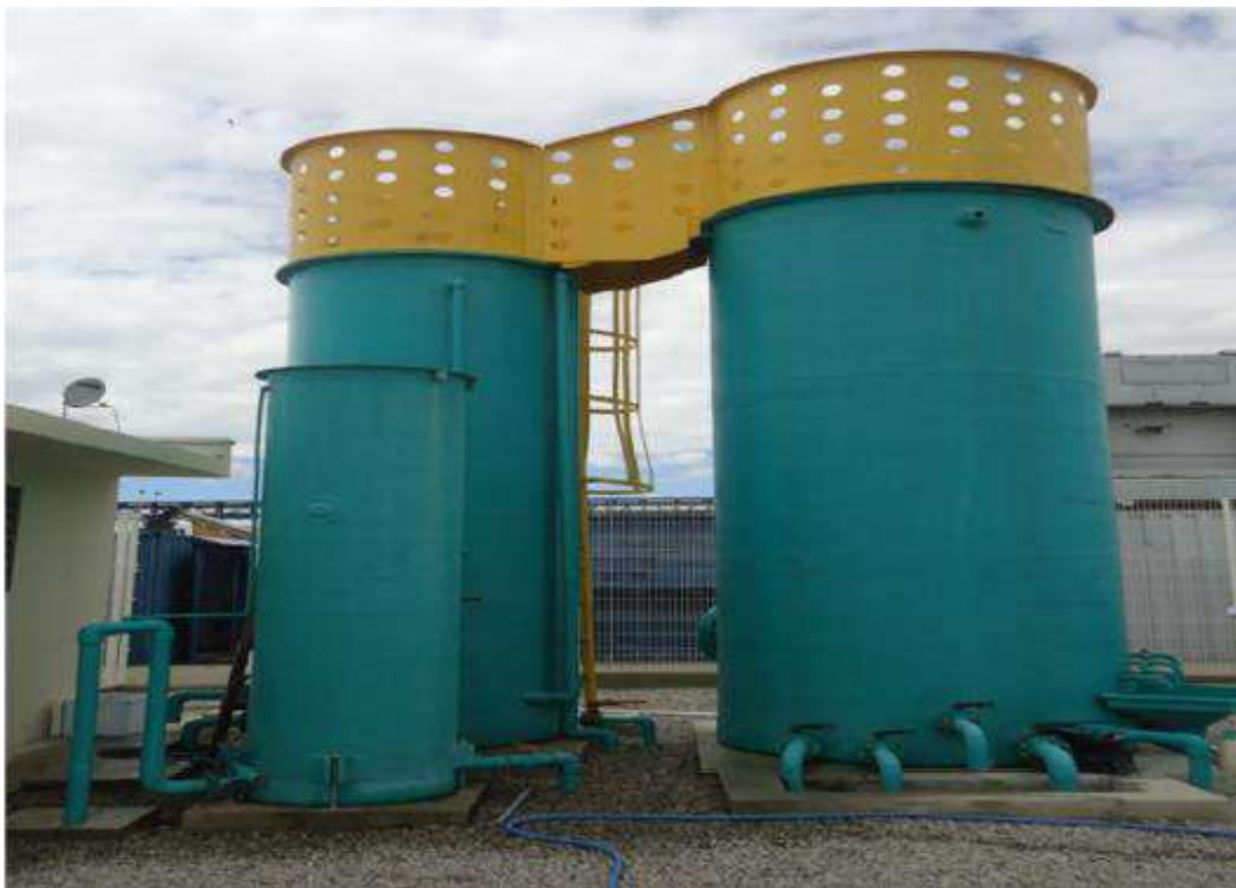
Figura 131 – ETE do Terminal Portuário do Pecém Fonte: CIPP (2018d).
