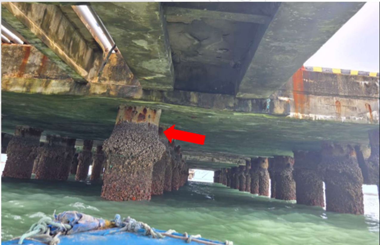
Imagem 02: Trecho do atracadouro com fundo abaixo do nível do resto da estrutura, e composto de laje maciça. Pode-se observar, pelas cracas, que o nível da maré chega até praticamente o nível da laje, não havendo espaço hábil para plataforma suspensa.
