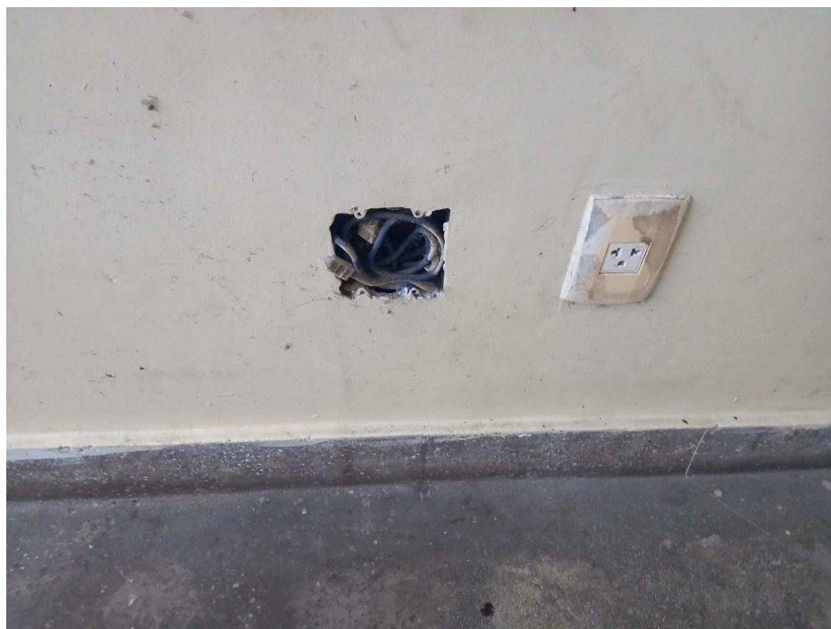
Foto 29: fiação exposta/ausência de caixa de tomada/painel espelho caixa de parede
