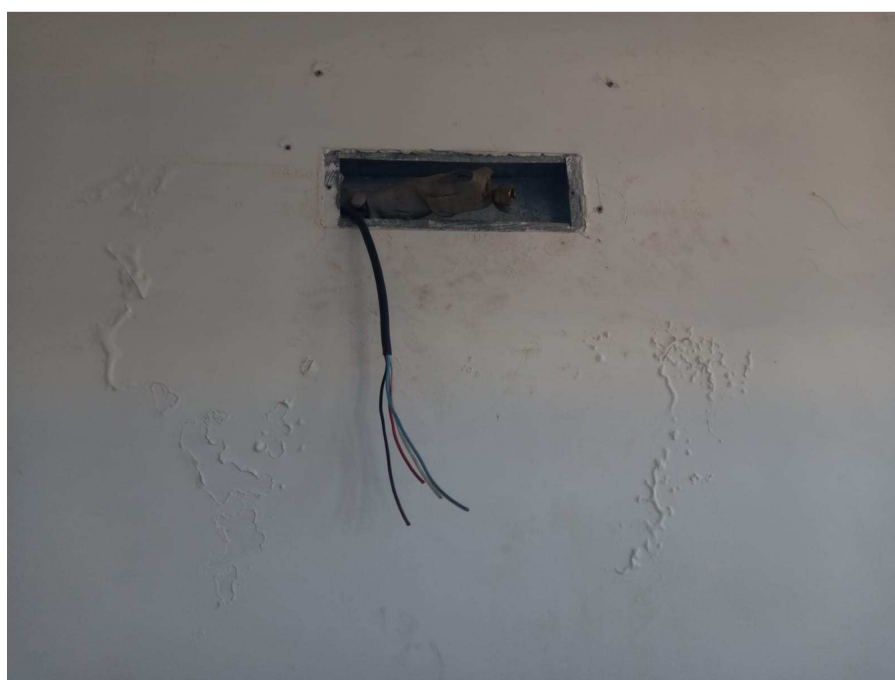
Foto 13: instalação de ar condicionado exposta
