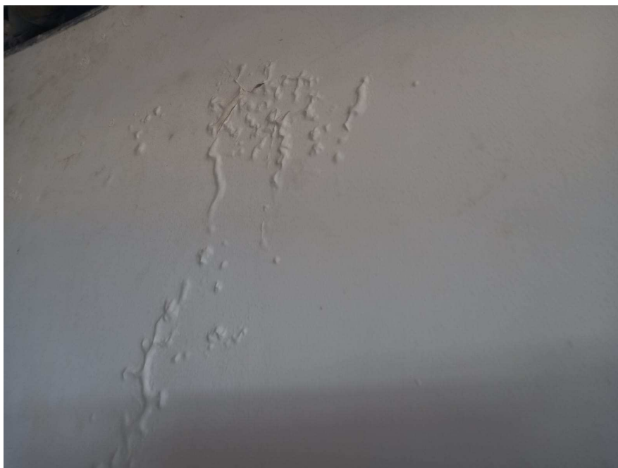
Foto 12: infiltração na parede
