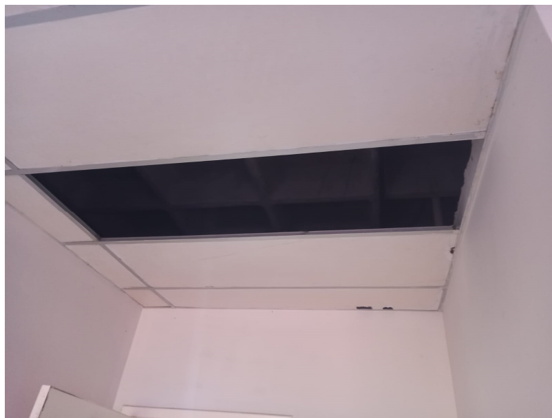
Foto 4: ausência de forro no teto
