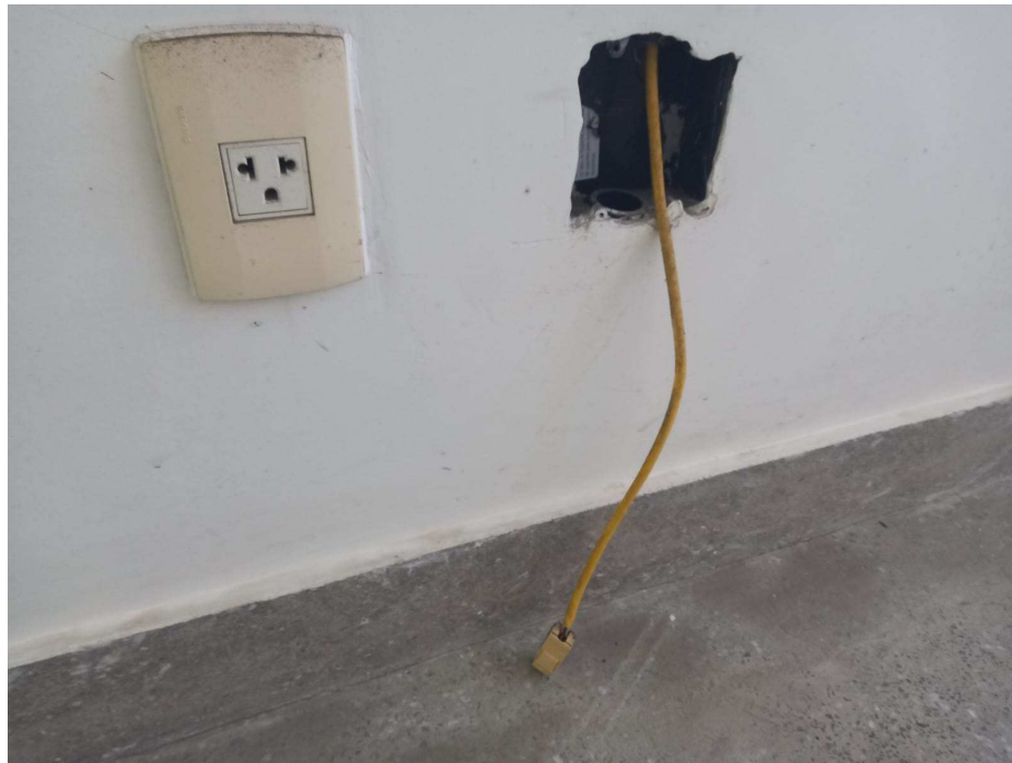
Foto 24: fiação exposta/ausência de caixa de tomada/painel espelho caixa de parede
