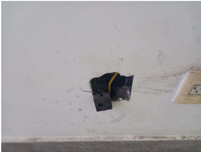
Foto17: fiação exposta/ausência de caixa de tomada/painel espelho caixa de parede
