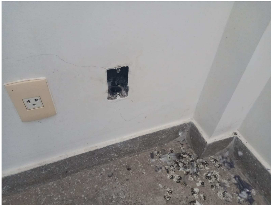
Foto 19: ausência de caixa de tomada/ painel espelho caixa de parede
