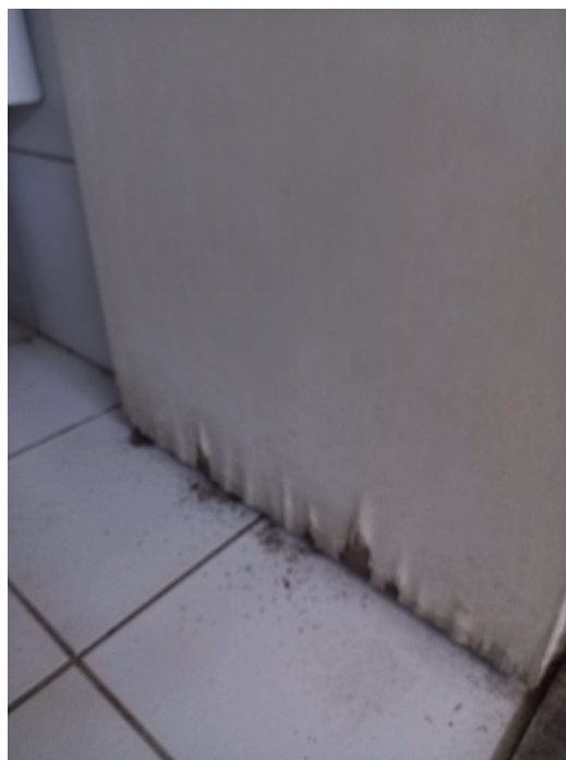
Foto 28: porta do banheiro avariada
