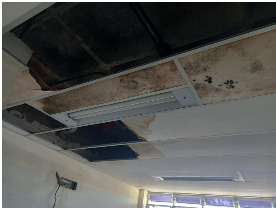
Foto 16: revestimento do teto (forro modular em PVC) em mau estado
