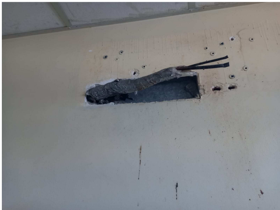
Foto 31: instalação de ar condicionado exposta
