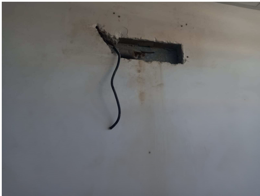
Foto 18: instalação de ar condicionado exposta
