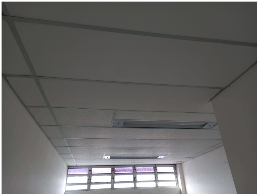
Foto 23: revestimento do teto (forro modular em PVC) em bom estado de conservação
