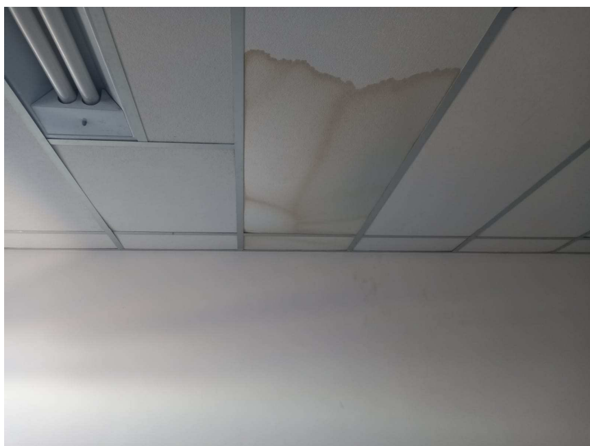
Foto 11: infiltração no forro do teto
