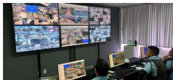
Figura: Monitoramento Remoto - CFTV
